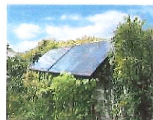
Les capteurs thermiques sont adossés à un mur du jardin. Cette solution demande une surveillance de la croissance de la végétation pour éviter toute ombre portée. Vigny (Val d'Oise) © PNR du Vexin français
