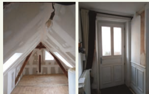
Deux exemples de travaux réalisés et financés par l'OPAH : l'isolation de plafond sous combles et la pose d'une porte d'entrée performante.
