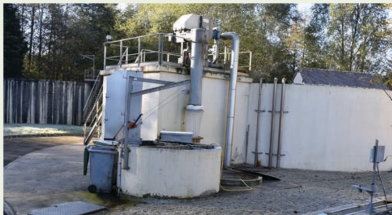
La station d'épuration de Longny-au-Perche va prochainement rentrer dans le giron de la CdC des Hauts du Perche.
